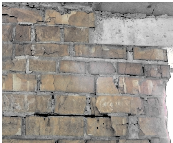
1 pav. Suaižėjusios mūro plytos
